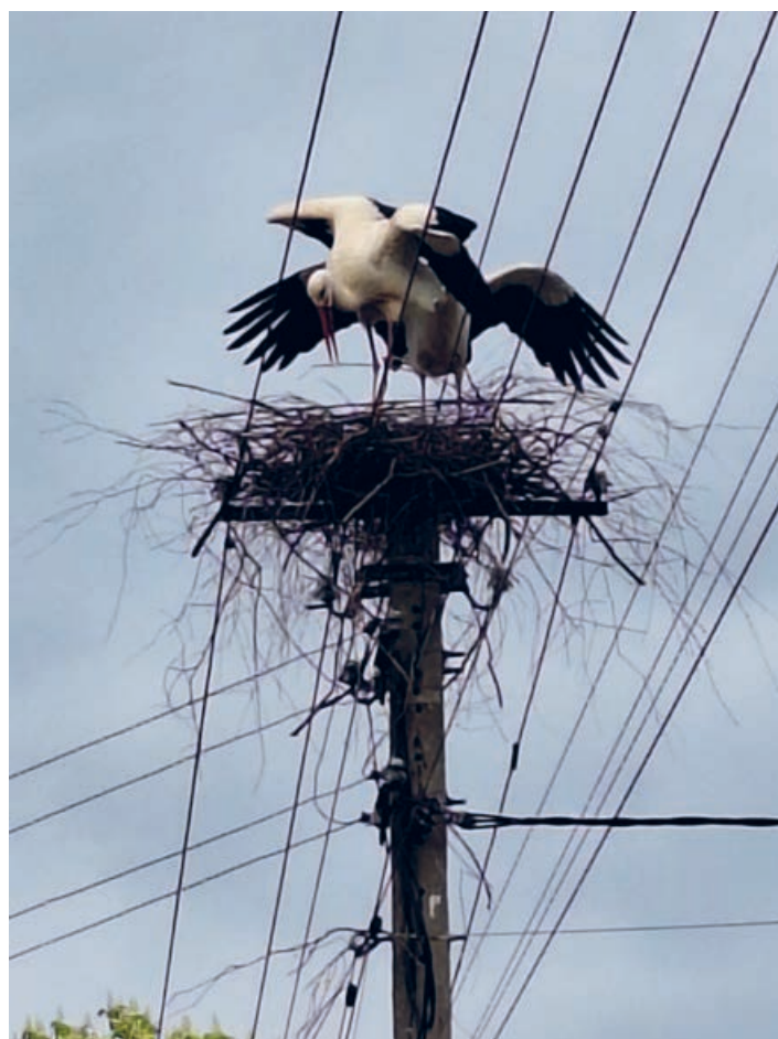
Stare gniazdo na linii wysokiego napięcia
